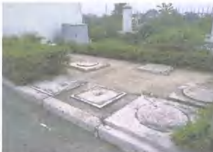
Hình 3. 6. Bể xử lý nước thải số 01
