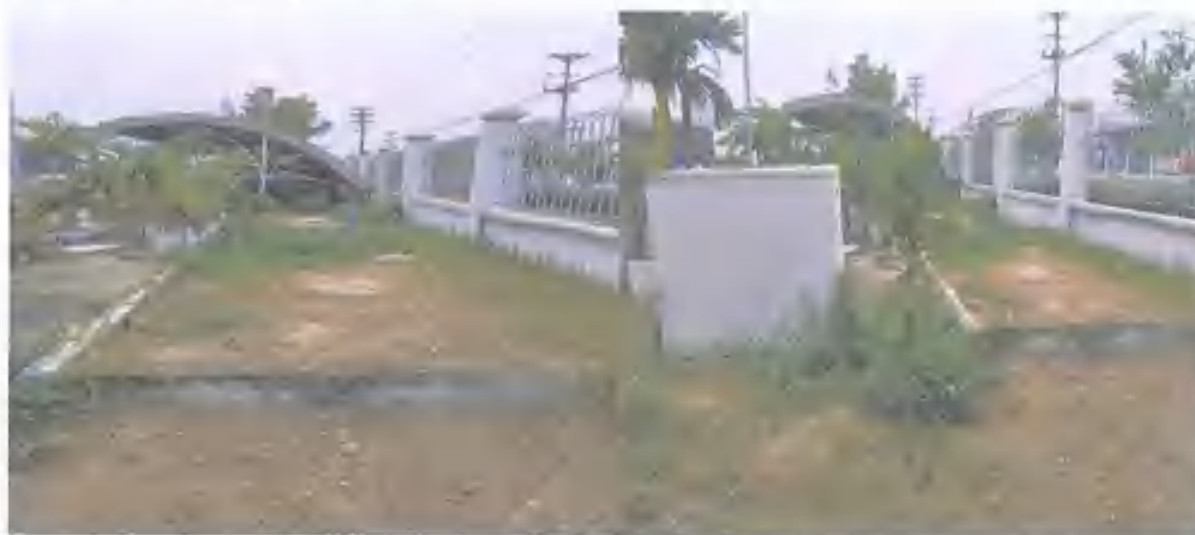
Hình 3. 8. Bể xử lý nước thải số 03
