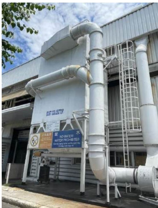
HTXL khí thải số 01 (xây dựng 2008)
