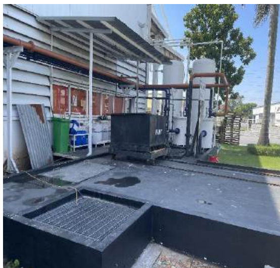
Bể lắng cặn 2 (xây dựng 2019)
