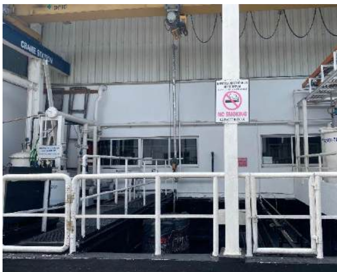
Bể lắng cặn 1 (xây dựng 2008)
