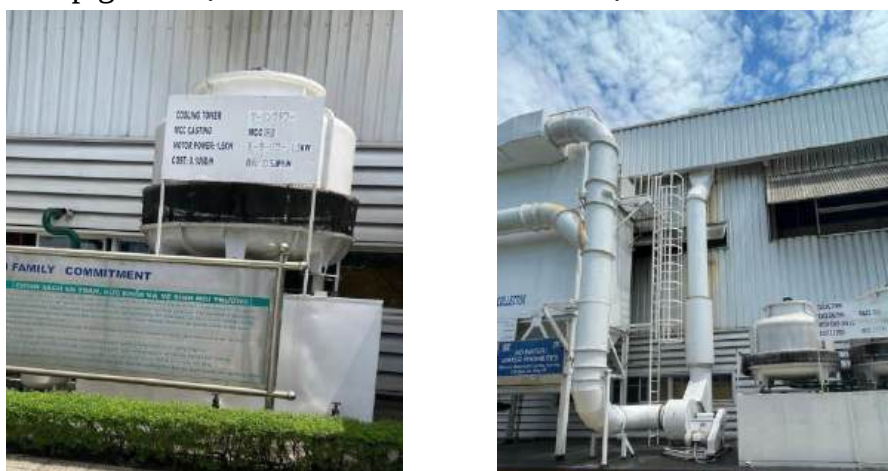
Hình 3. 11. Hình ảnh tháp giải nhiệt và Bể chứa
