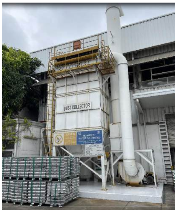
HTXL khí thải số 02 (xây dựng 2019)
