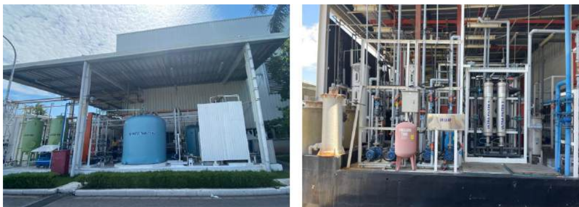
Hình 1. 8. Hình ảnh 02 Hệ thống xử lý nước cấp
