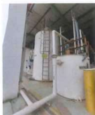
Đường ống thoát nước thải.
