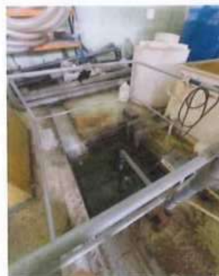
Hồ thu nước thải từ quá trình Bảo trì
