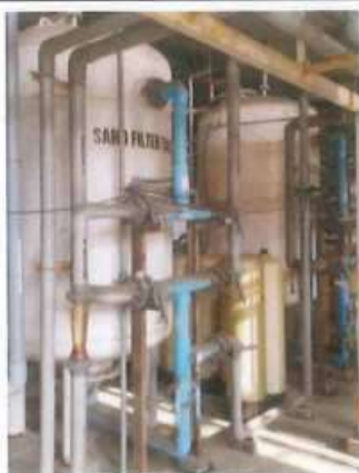
Lọc cát, lọc than hoạt tính
