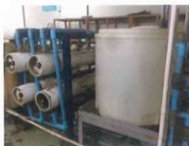
Hệ thống rửa màng lọc thẩm thấu ngược RO
