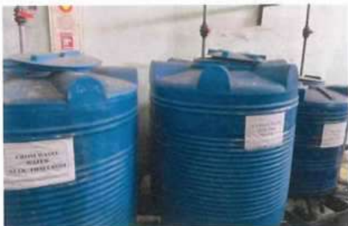
Bể chứa nước thải từng loại
