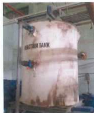
Bể phản ứng
