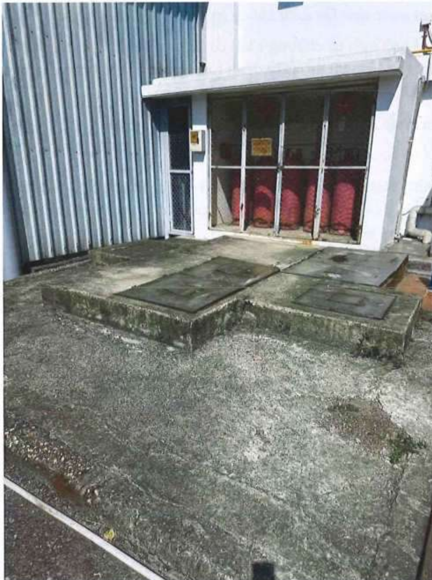
Hình 3.4. Hình ảnh bể tách mỡ tại nhà máy
