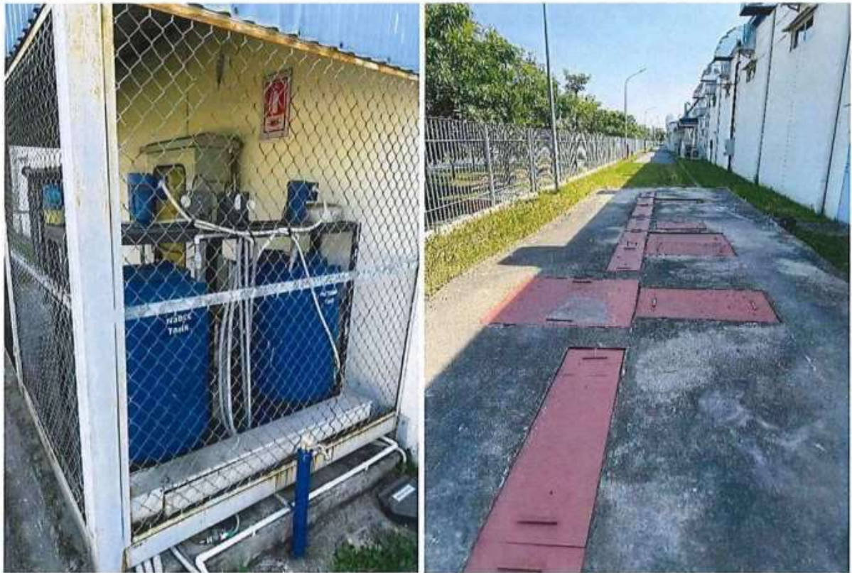
Hình 3.7. Hình ảnh hệ thống xử lý nước thải sinh hoạt tại cơ sở
