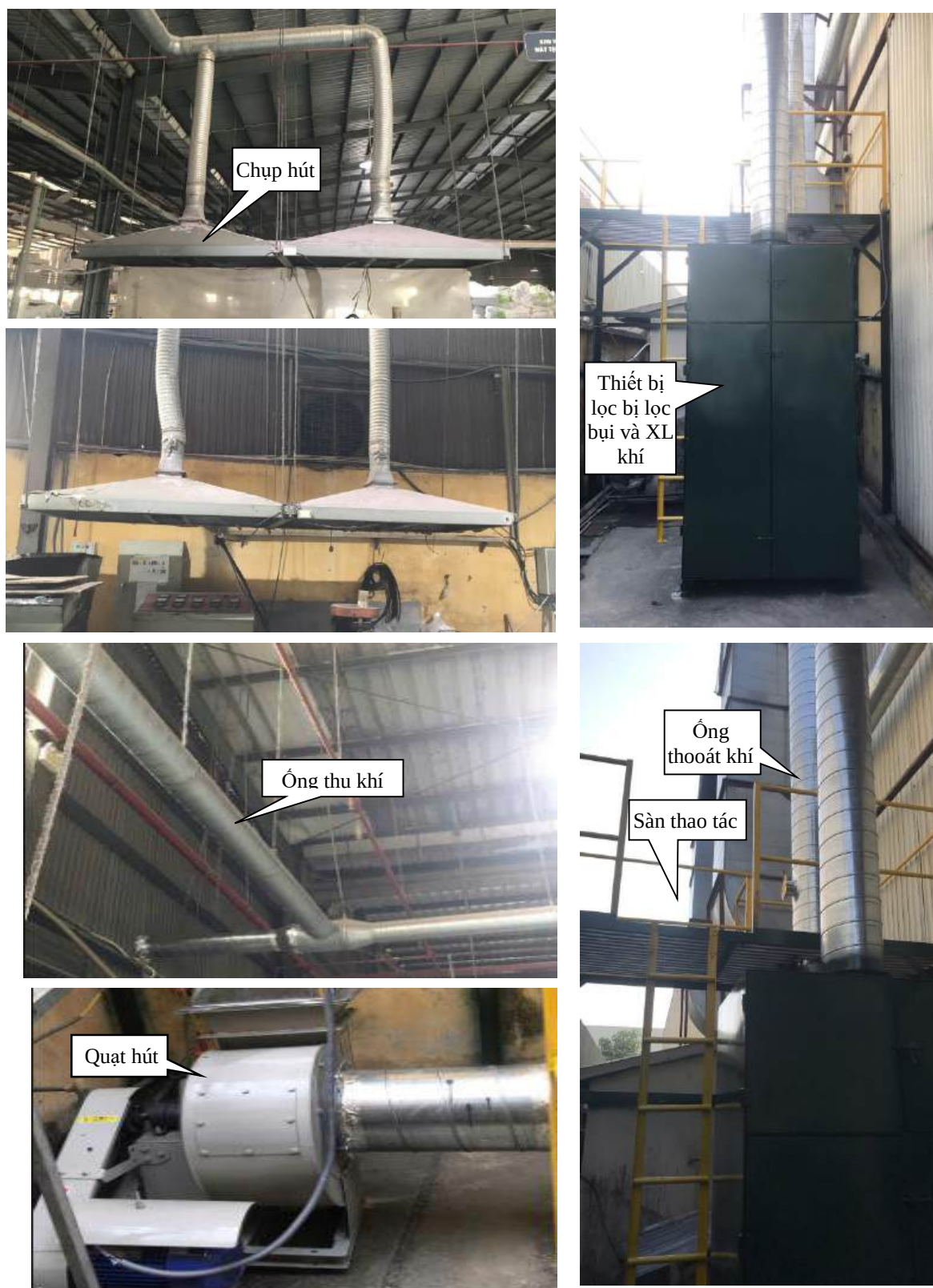
Hình 25. Hệ thống xử lý khí thải của nhà máy
