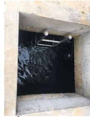
Bể nước chữa cháy
