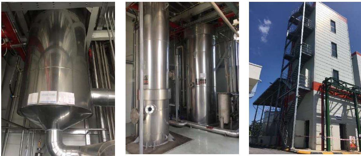
Hình 12: Ảnh thực tế hệ thống chưng tách nước glycol
