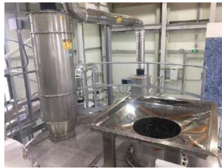
Thiết bị rung giữ bụi tại phễu cân H702
