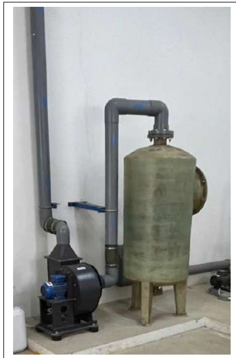
Hình 22: Hệ thống xử lý khí thải của hệ thống xử lý nước thải tập trung.
