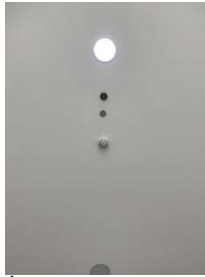
Hệ thống phát hiện và chữa cháy
