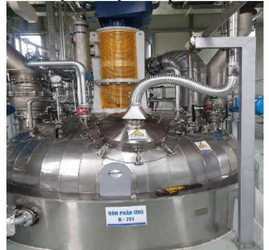
d) Chụp hút tại Bồn phản ứng R-701
