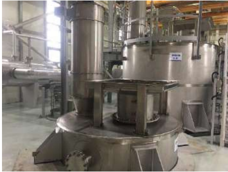
Thiết bị rung giữ bụi tại phễu cân H601
