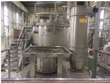
Thiết bị rung giữ bụi tại phễu cân H701
