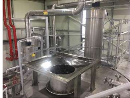
Thiết bị rung giữ bụi tại phễu cân H602
