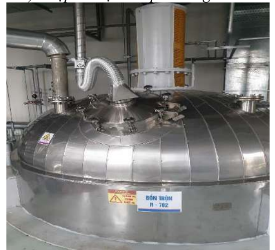
f) Chụp hút tại Bồn trộn R-702
