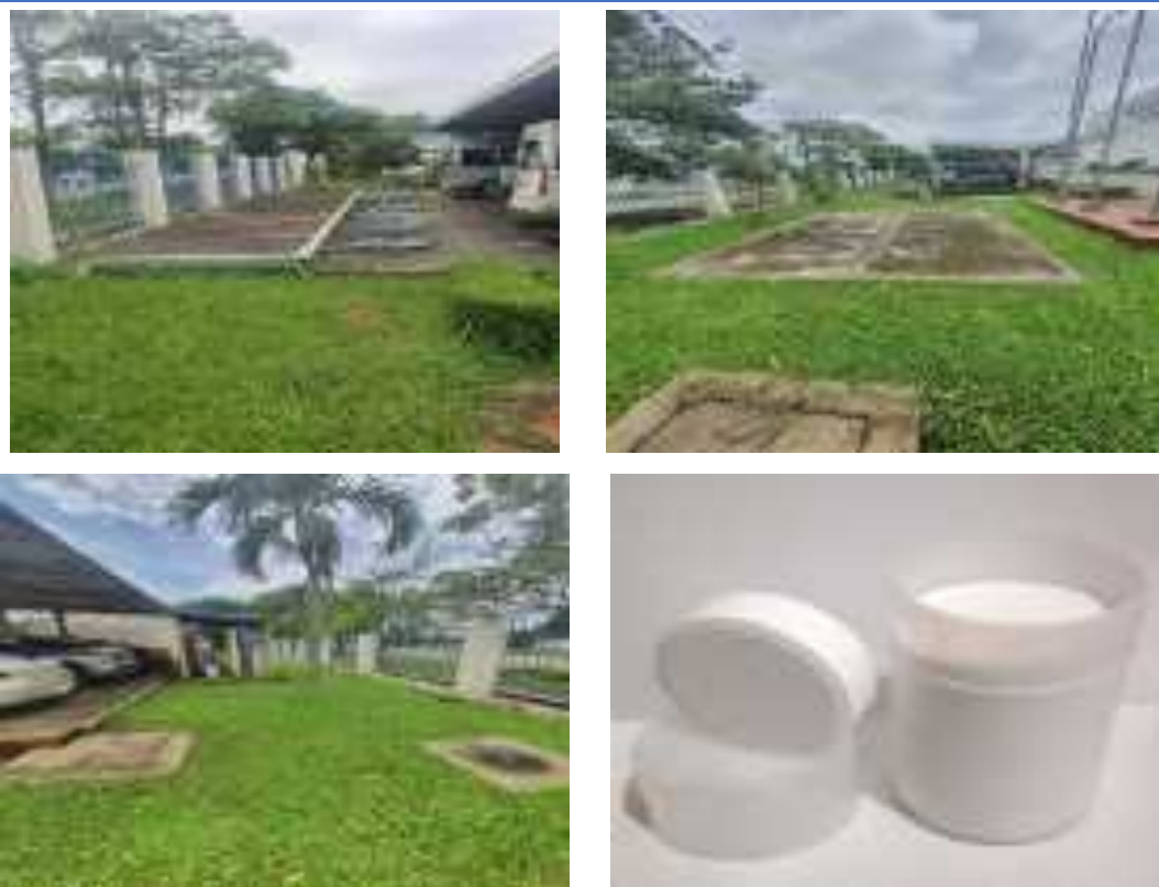
Hình 3.6. Hệ thống xử lý nước thải sinh hoạt cơ sở
