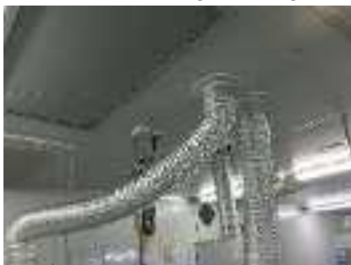
Hình 3.7. Hệ thống chụp hút và đường dẫn khí dây chuyền sơn
